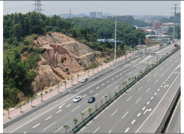
K45+100 左侧边坡出现坍塌
