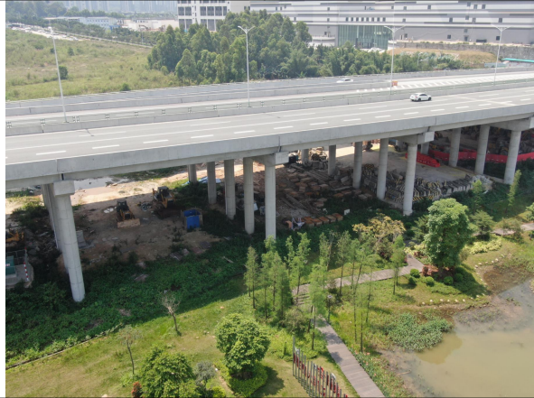
大雁山互通主线桥底部分区域裸露
