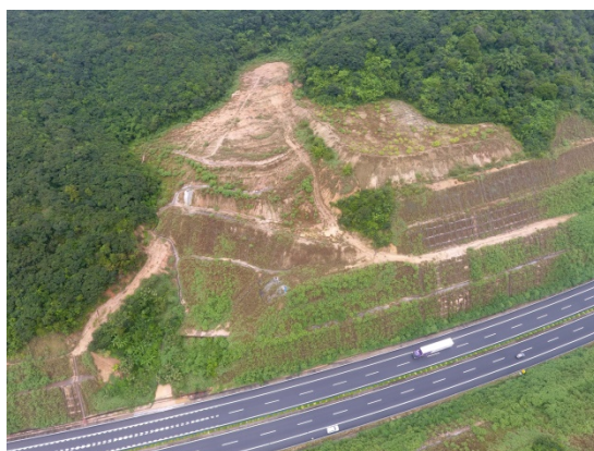
K54+000 右侧堆体
