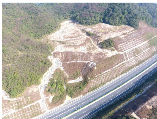
K54+000 右侧堆体
