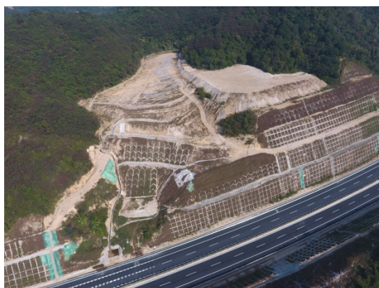
K54+000 右侧堆体
