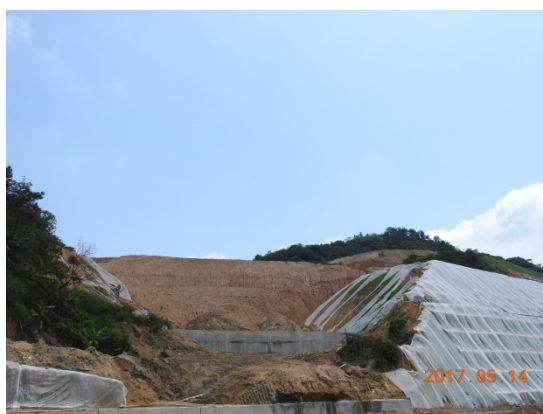
K54+000 右侧堆体
