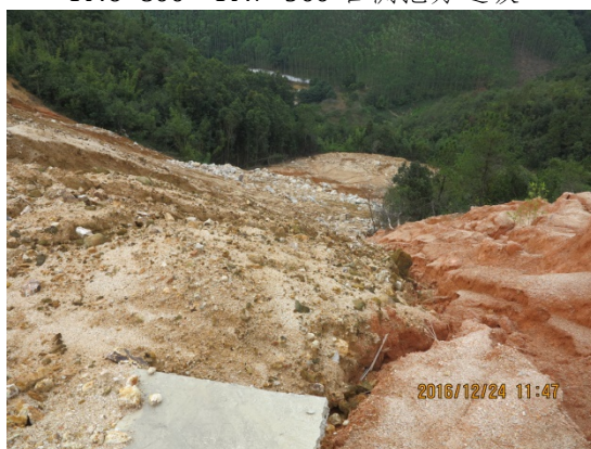
K3+480 右侧弃渣场
