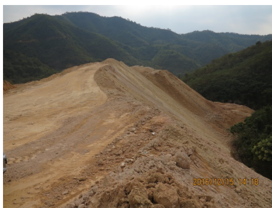
K54+000 右侧堆体
