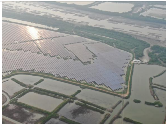
位置：光伏阵区 现场：光伏组件施工完成后，下部蓄水恢复渔业养殖，低压交流电缆通过桥架输送到箱变
