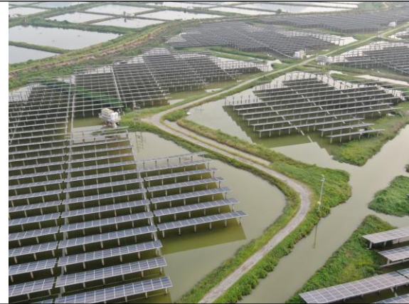
位置：光伏阵区 现场：光伏组件施工完成后，下部蓄水恢复渔业养殖，低压交流电缆通过桥架输送到箱变
