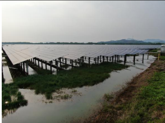
位置：光伏阵区 现场：光伏组件施工完成后，下部蓄水恢复渔业养殖，低压交流电缆通过桥架输送到箱变
