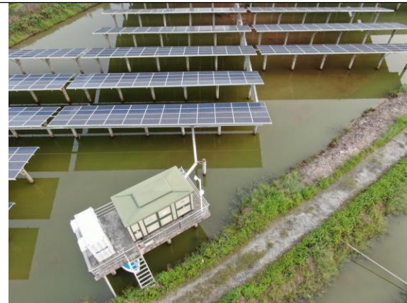
位置：光伏阵区 现场：光伏组件施工完成后，下部蓄水恢复渔业养殖，低压交流电缆通过桥架输送到箱变
