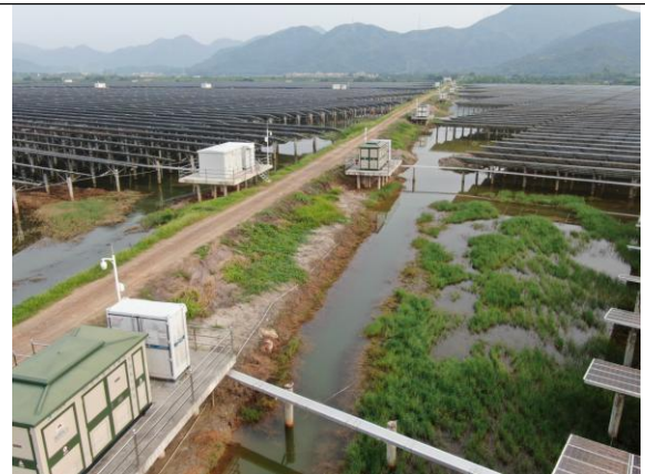
位置：检修道路 现场：检修道路两侧土路肩及填筑边坡实施植被恢复措施，路面采用碎石路面
