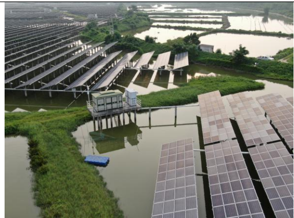
位置：光伏阵区 现场：光伏组件施工完成后，下部蓄水恢复渔业养殖，低压交流电缆通过桥架输送到箱变
